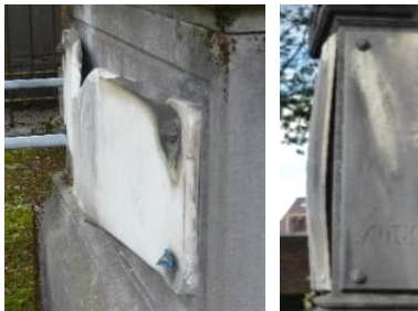
De plaat is gebogen
