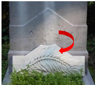
De plaat is losgekomen
